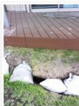
外構の一部が損壊
